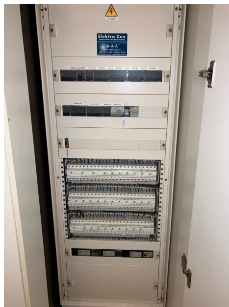
( Elektrisch bord - binnenkant )
