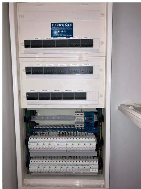
( Elektrisch bord - binnenkant )
