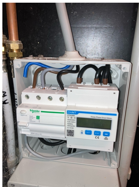
(Elektrisch bord - binnenkant)
