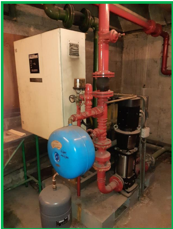
Figuur 5: Waterdrukpomp: geen asbest.
